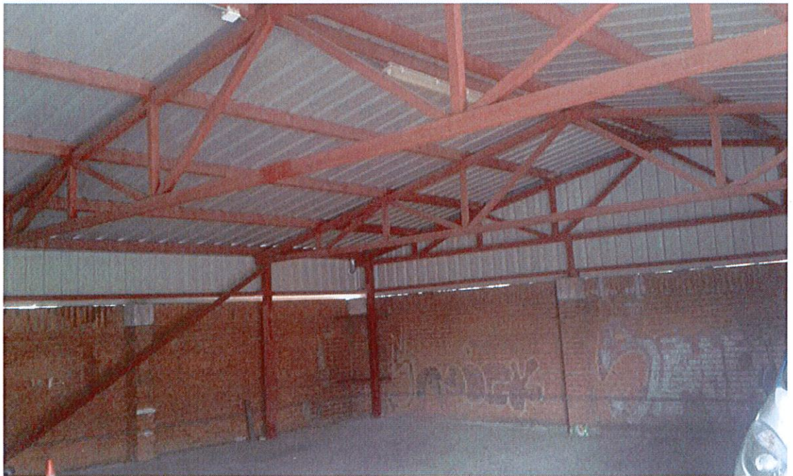
Cerramientos oeste (a calle) y sur (a patio colindante). Ejecutar aislamiento.
