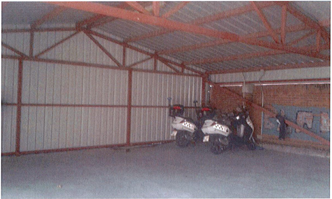
Cerramientos este (a patio propio) y sur (a patio colindante). Ejecutar aislamiento.
