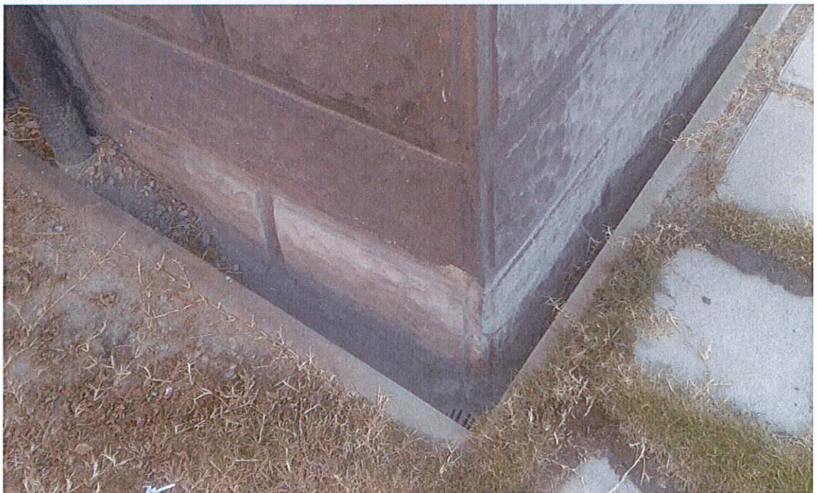
Canaleta a reformar.
