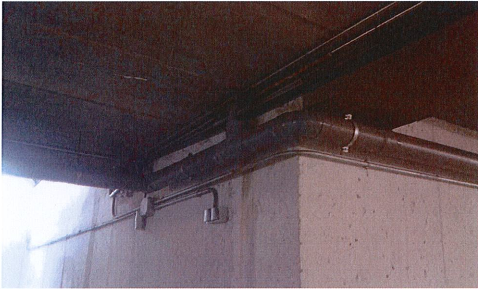
Saneamiento de aguas pluviales en techo de garaje. Bajo canaleta a reformar.
