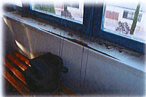
Aspecto general del estado actual de las repisas Oeste y Sur Falta de estanqueidad por ausencia de vierteaguas exterior
