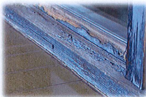
Aspecto general del estado actual en ventanas Oeste y Sur Ausencia de vierteaguas y canal de evacuación obstruido
