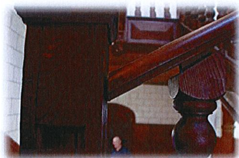
Vista Pilastra y Balaustre desenchajado Encolar y aplomar a su sitio
