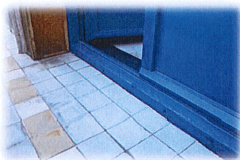
Viertaaguas instalada en Despacho Jefe Distrito Ausencia de patologías
