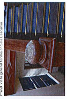
F05 Remate circular desgastado
