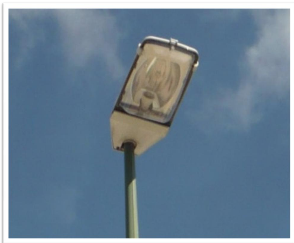
Imagen 4: una de las luminarias instaladas en el camino de Callejuelas.
