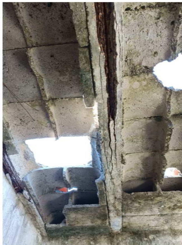
Fotografía 16 - vigüeta tipo 4 y desprendimiento de bovedilla
