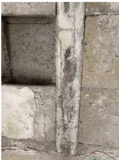
Fotografía 9 - vigueta tipo 3 y desprendimiento de suela en bovedilla
