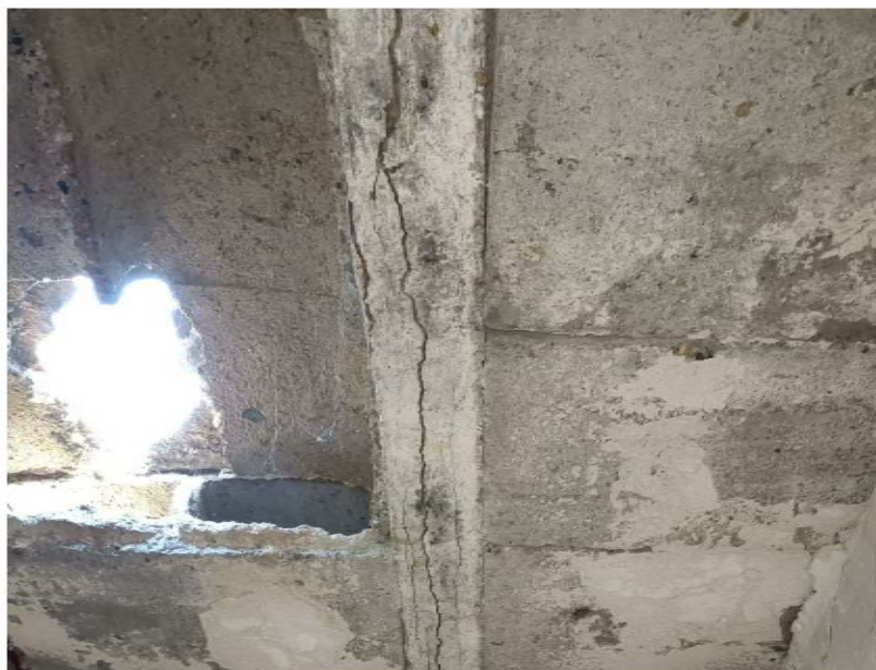
Fotografía 10 - vigueta tipo 3 y desprendimiento de bovedilla
