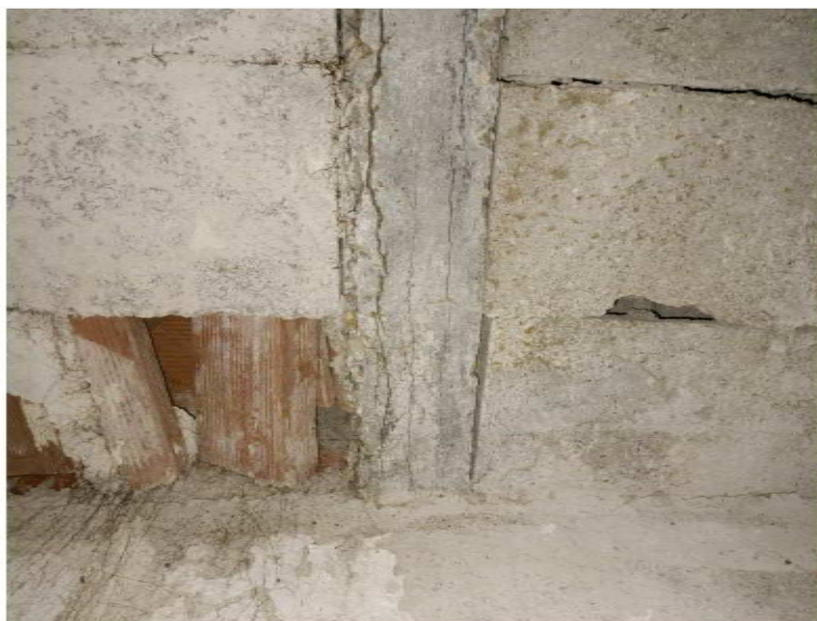
Fotografía 14 - vigüeta tipo 3 y desprendimiento de suela en bovedilla
