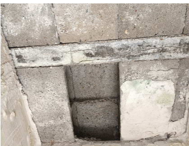
Fotografía 12 - vigueta tipo 3 y desprendimiento de suela en bovedilla
