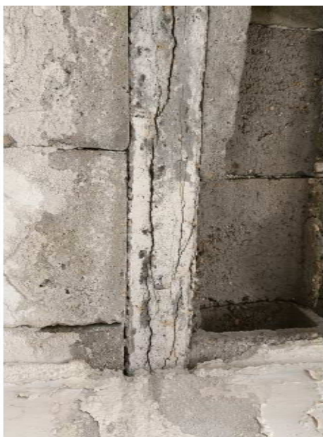
Fotografía 11- vigueta tipo 3 y desprendimiento de suela en bovedilla
