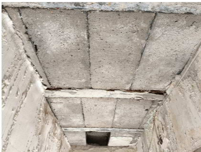
Fotografía 8 - vigueta tipo 2 y desprendimiento de suela en bovedilla
