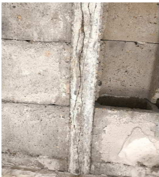
Fotografía 13 - vigüeta tipo 3 y desprendimiento de suela en bovedilla
