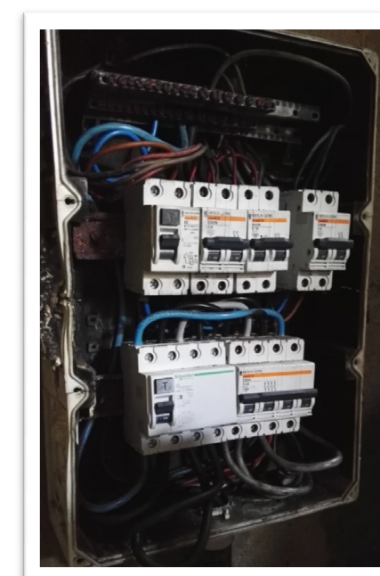
Imagen 4: estado actual del cuadro eléctrico principal.
