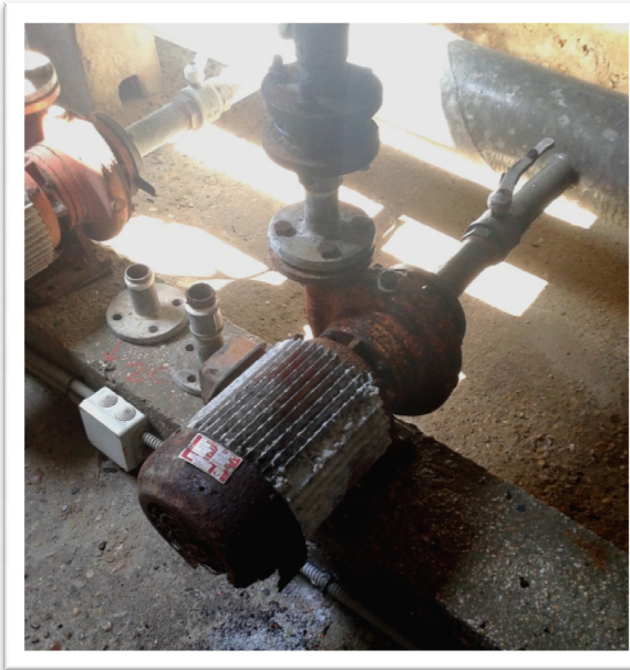
Imagen 1: estado actual de uno de los equipos de bombeo del periférico.
