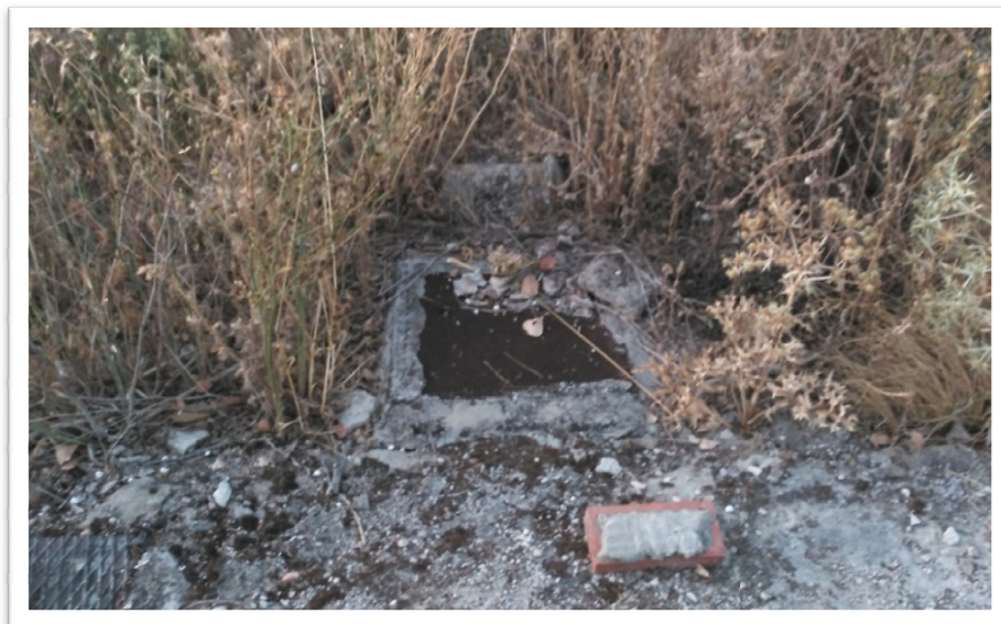
Imagen 2: estado actual de una rejilla de ventilación de la sala de bombeo y control.
