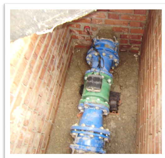
Imagen 3: Caudalímetro no operativo. Tubería de salida del periférico.
