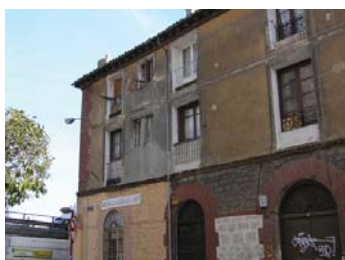
Edificio con un alto grado de deterioro en el inicio del Paseo Arco de Ladrillo.
